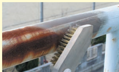
2. 下地調整 下地の種類やさびの発生程度によって 適正なケレン作業を行う
