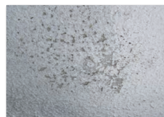
塗膜の剥がれ
